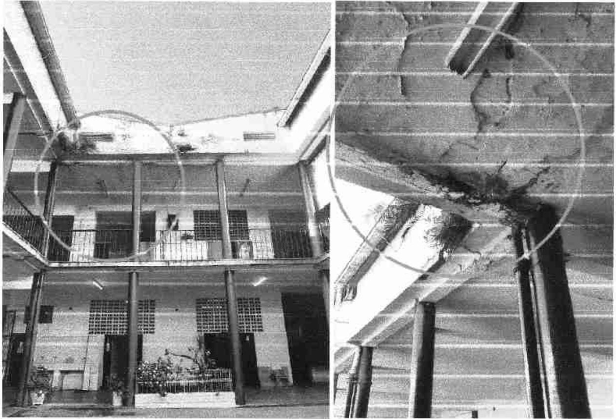
Sector en planta marcando el área que esta con roturas.
