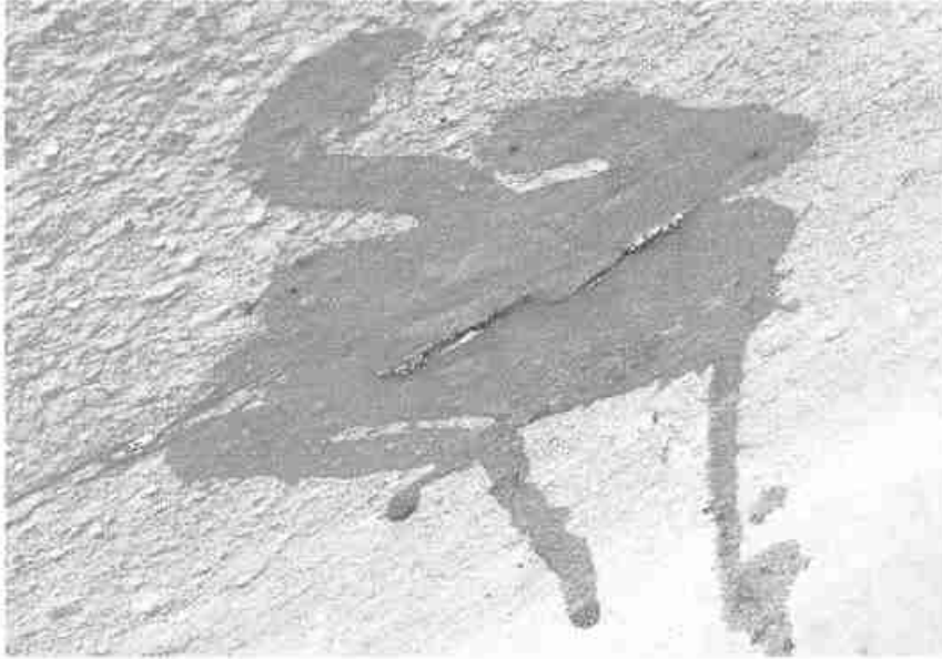
Imagen 3: Grieta horizontal, sobre 30 del nivel de piso
