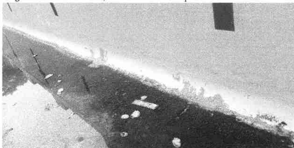
Imagen 2: Grieta horizontal, sobre 30 del nivel de piso
