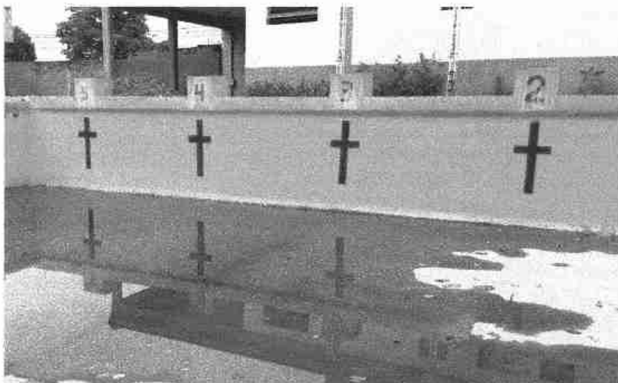
Imagen 1: Grieta horizontal, en la extensión de la pileta
