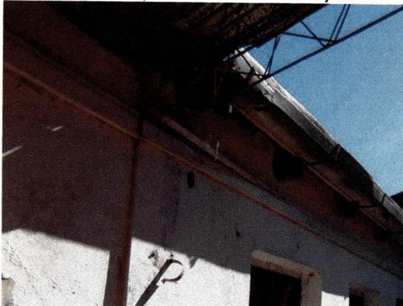
Canaletas oxidadas y ausencia de caños de bajada
